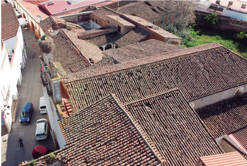
Fig. 2. Vista en la que puede apreciarse el grado de deterioro del edificio conventual en 2022.
